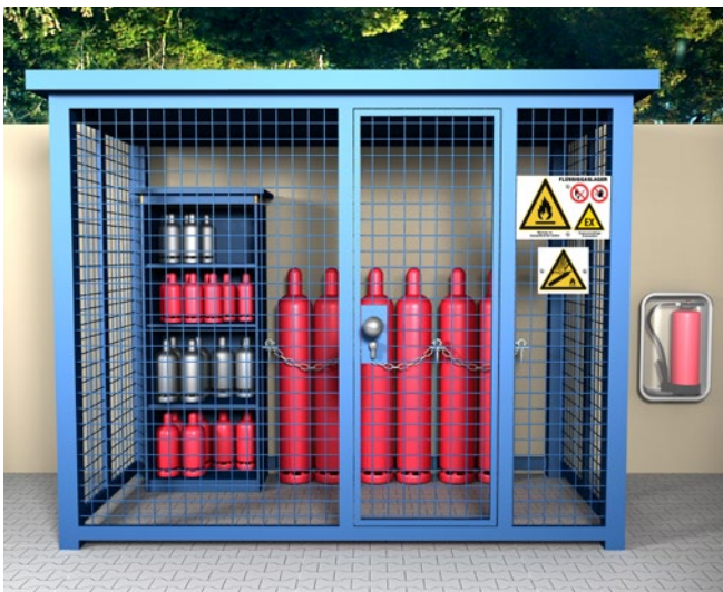
Abb. 32 Lagerung von Flüssiggasflaschen im Freien
