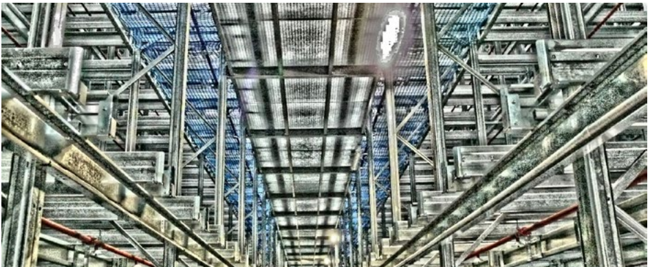
Abb. A2.1 Wartungssteg mit Hochregallagersicherungsnetzen
